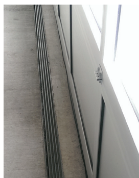
Installazione davanti agli ingressi per prevenire la formazione di ghiaccio
